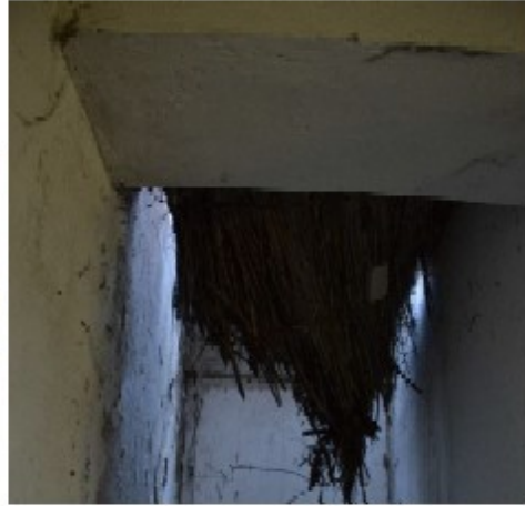
44. ábra Kőszekedőtér beszakadt födeme
