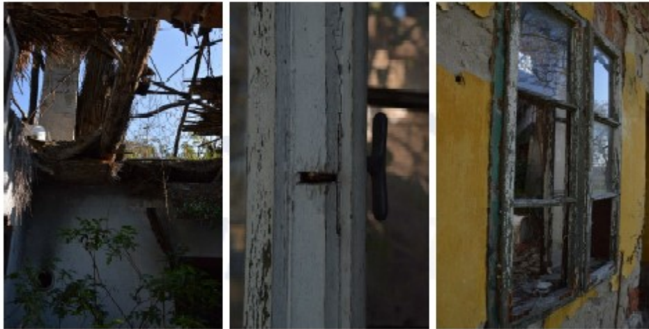
34. ábra Északi épületrész beszakadt födémrészlete 35. ábra Aiu ablakfordító 36. ábra Pallótokos ablak az északi szárnyon
